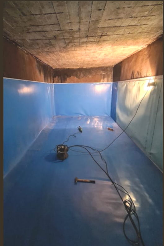
Jímka na pitnou vodu Javorné 2021
